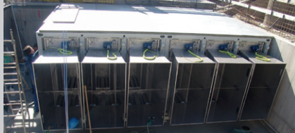
ECCODUST Wienerwald, exhaust air
